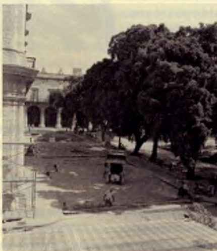
Restauración de los adoquines de la calle Tacón, frente a la fachada principal del Palacio de los Capitanes Generales, hoy Museo de la Ciudad.
