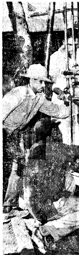
...con esta máquina se hacen las calas para el parque soterrado en el Parque Central de la Habana.
