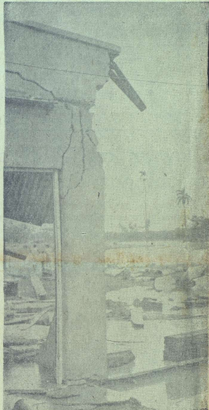
El aspecto desolador de estas ruinas pueden dar una idea de la terrible catástrofe sufrida por nuestra Patria, en las provincias asoladas por el huracán. En el primer plano se puede observar un pedazo de pared que quedó en pie, con una profunda grieta, de una casa en Camagüey.
