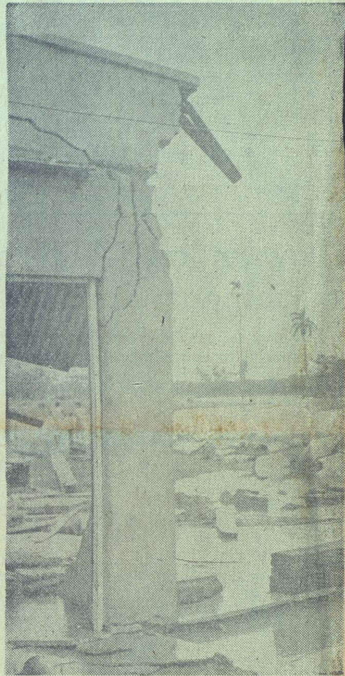
El aspecto desolador de estas ruinas pueden dar una idea de la terrible catástrofe sufrida por nuestra Patria, en las provincias asoladas por el huracán. En el primer plano se puede observar un pedazo de pared que quedó en pie, con una profunda grieta, de una casa en Camagüey.
