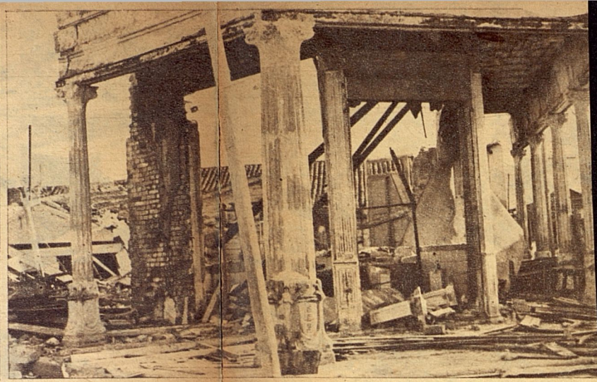
Esto fué uno de los mejores edificios del pueblo de Unión de Reyes, que ahora sólo tiene unas columnas agrietadas y en peligro de derrumbarse a cada instante...
