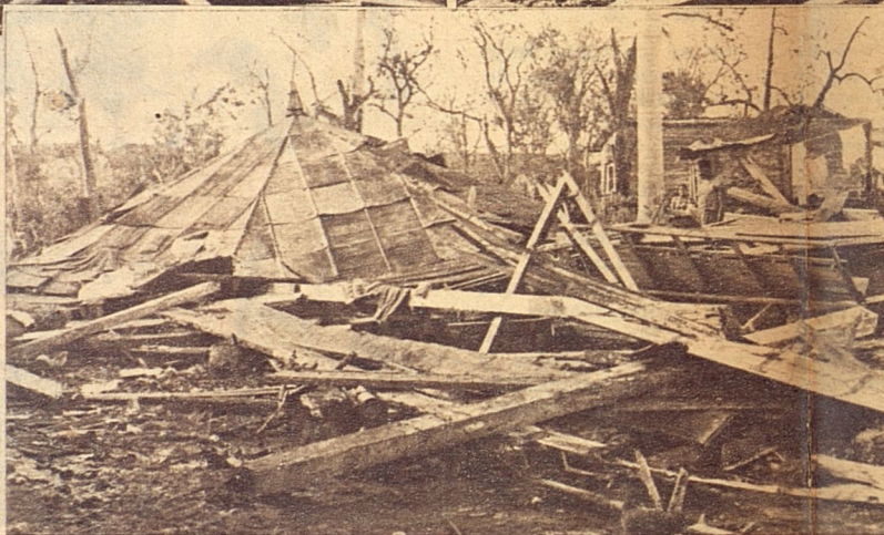
Pocas son las edificaciones que han quedado en pie en Unión de Reyes... La inmensa mayoría son como ésta, montañas de maderas, hierros y ladrillos!...
