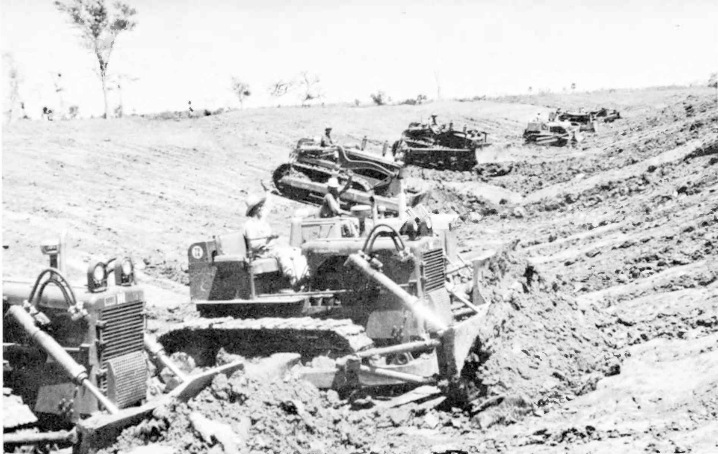
SEPTIMO PASO EN LA ROTURA DEL DIQUE QUE SUJETABA LAS AGUAS DEL RIO SALADO
