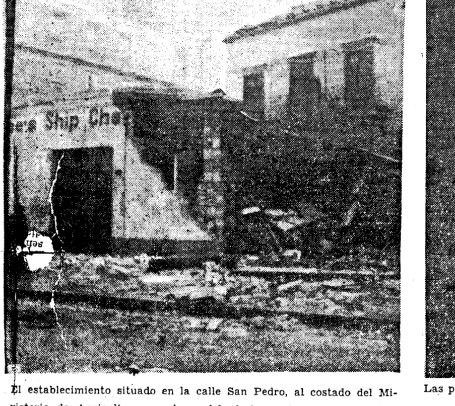
El establecimiento situado en la calle San Pedro, al costado del Ministerio de Agricultura, se derrumbó, destruyendo en su caída los techos y una gran cantidad de mercancías allí depositadas.
