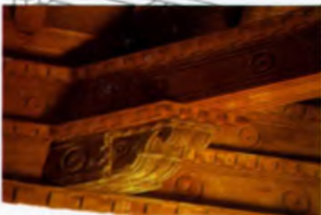
La armadura de par e hilara forma una sección geométrica (triángulo isósceles) de modo que todos los pares se apoyan en el vértice (hilara o cumbrera) mientras que unos tirantes horizontales contrarrestan la tendencia de los pares a separarse.
