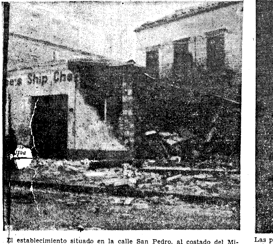
El establecimiento situado en la calle San Pedro, al costado del Ministerio de Agricultura, se derrumbó, destruyendo en su caída los techos y una gran cantidad de mercancías allí depositadas.
