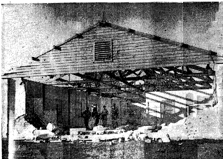
Estado en que quedó el hospital del campamento de Managua, después que el ciclón lo dejó inservible, cuya reparación se acometerá rápidamente.
